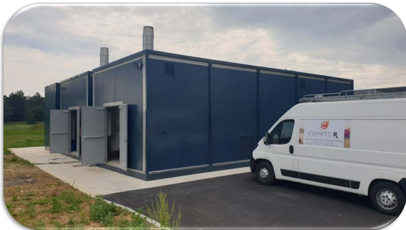
Värmecentraler med inbyggda mellanförråd.
