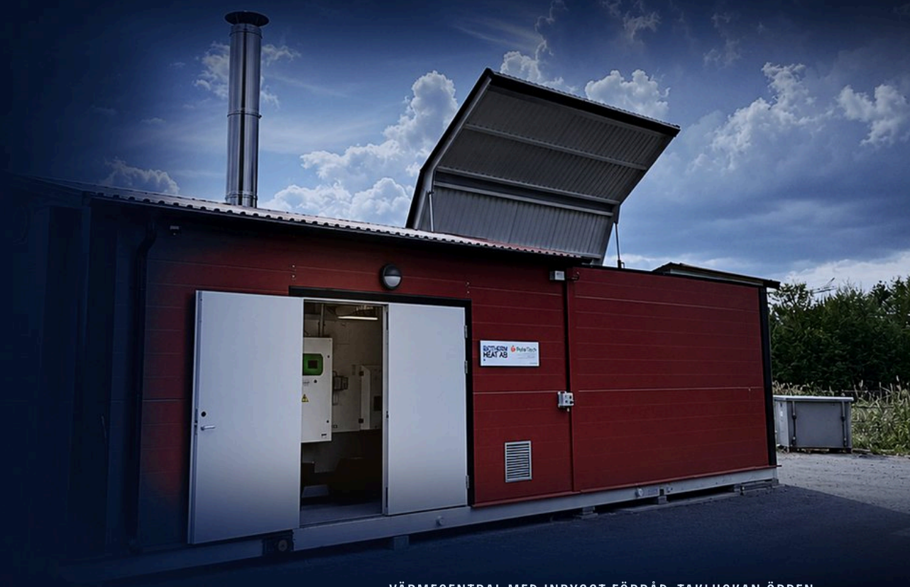
VÄRMECENTRAL MED INBYGGT FÖRRÅD, TAKLUCKAN ÖPPEN
